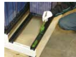
Abb. 5-12: Behandlung der Abstellschienen
