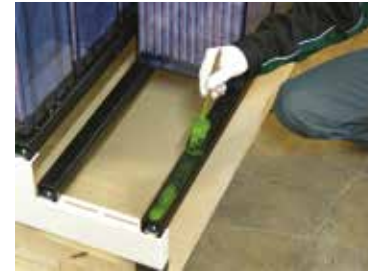
Abb. 5-13: Behandlung der Abstellschienen
